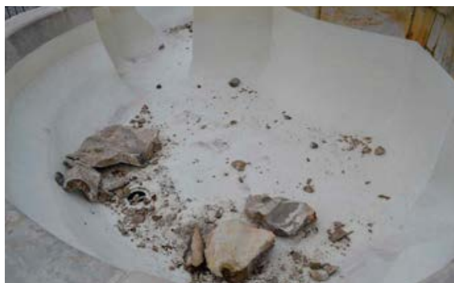
Fot. 6–7. Zniszczenie górnej misy z niewyjaśnionych przyczyn. Na dolnej fotografii widoczne fragmenty misy oraz masa zabezpieczająca basen dolny, 2012 rok
