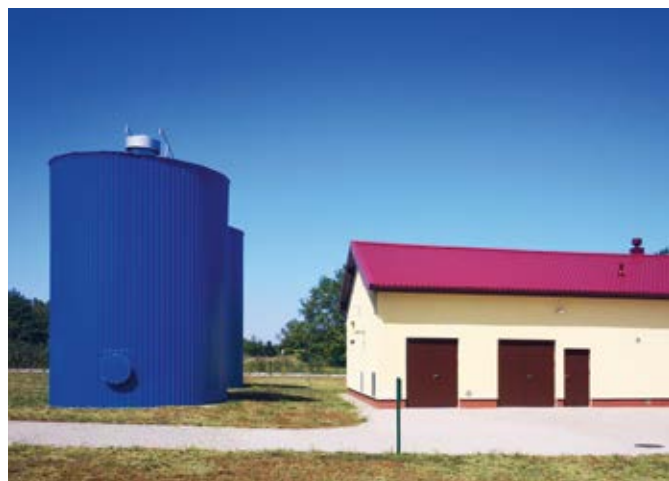
Fot. 3. Zbiorniki i hydrofornia w Buku
