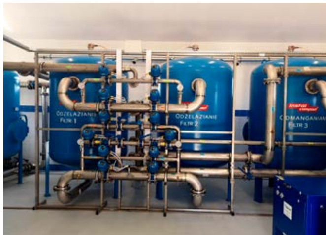
Fot. 4. Wyposażenie hydroforni w Buku
